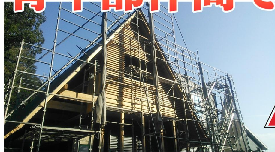
福岡市南区の閑静な住宅街の中でも一番の高台に建築中
